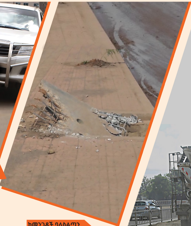
ከመንገዶች ባለስልጣን በማንሆል ክዳን ላይ የደረሰ ጉዳት
